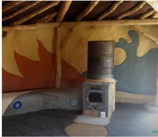
Figure 4 : Rocket stove construit par Pascal
