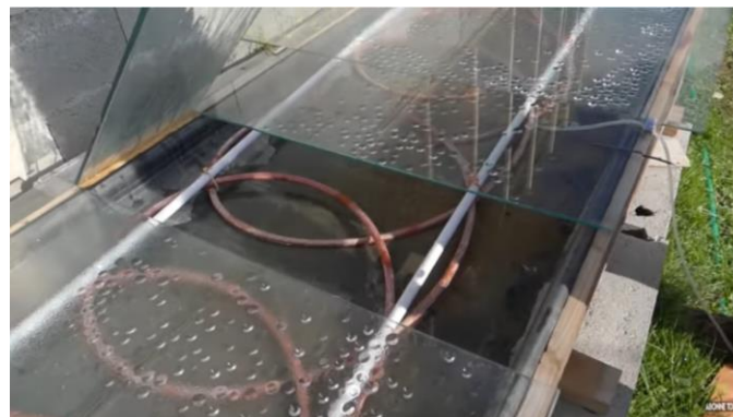
Figure 8 : Bac extérieur servant à chauffer l'eau
